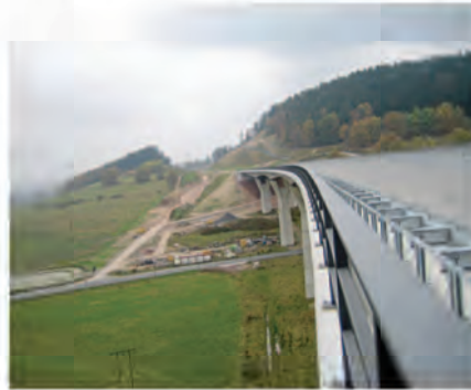
Verbindungen schaffen: Brückenbau im Zuge des Neubaus der A 73. (Foto: Bieber + Marburg)
